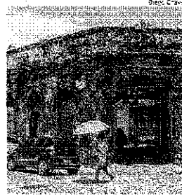
Imóvel no Centro Histórico em estado precário
